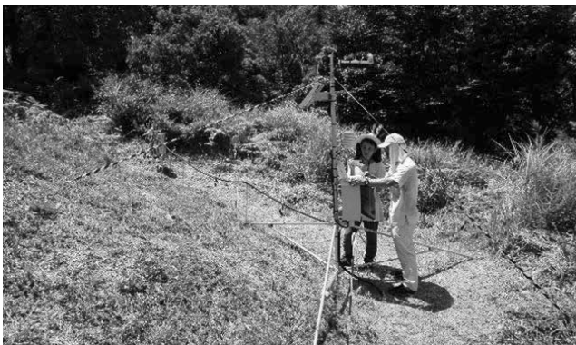
写真5 気象観測ステーション設置状況
